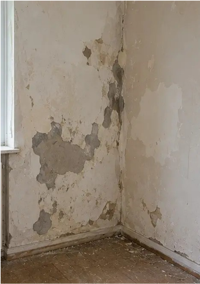
写真 №3 補修工事前の壁の状態
