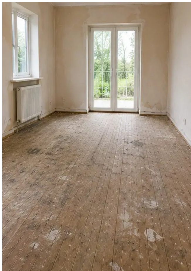
Foto №5 Stato della pavimentazione prima della sostituzione
