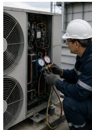
Foto №6. Stato delle apparecchiature HVAC documentato
