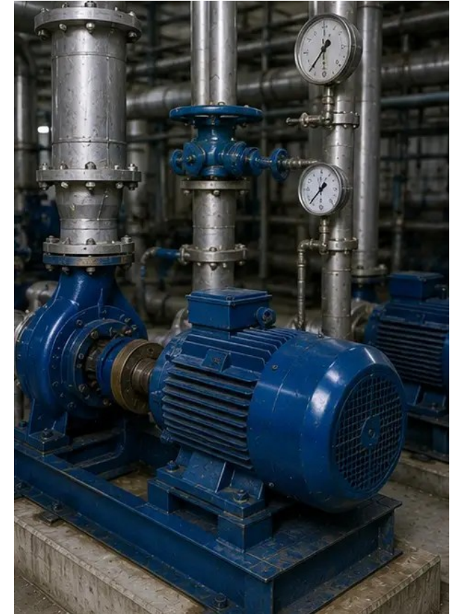
Foto №15. Apparecchiature funzionanti normalmente dopo la manutenzione
