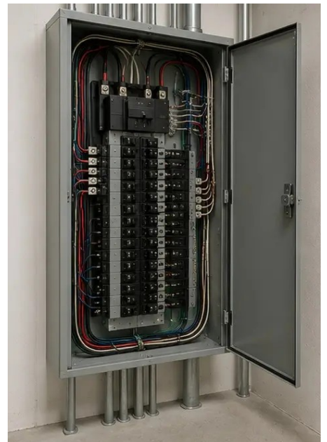
Photo #9. Stato del quadro elettrico documentato
