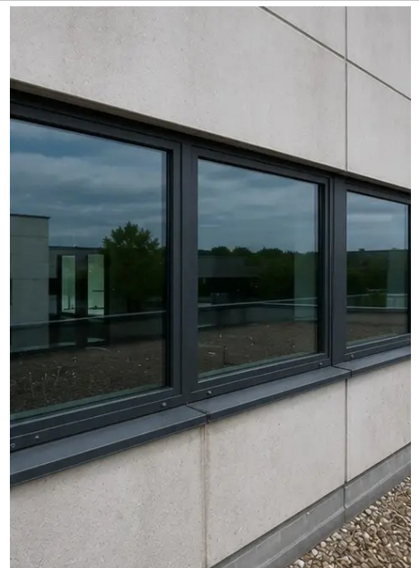
Photo #6. Stato delle finestre documentato durante l'ispezione
