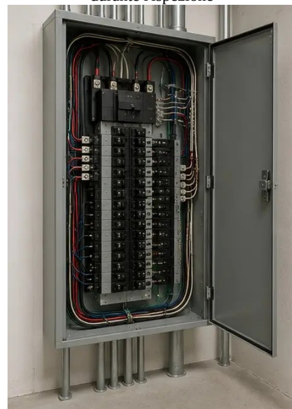
Photo #9. Stato del quadro elettrico documentato
