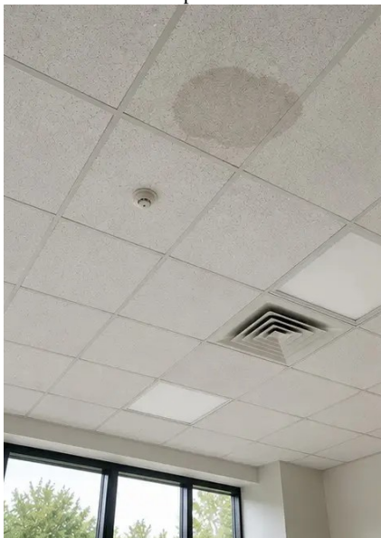
Photo #13. Stato del soffitto documentato durante l'ispezione
