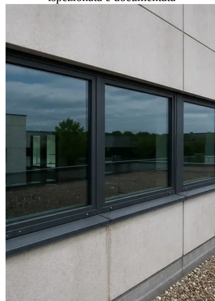
Photo #6. Stato delle finestre documentato durante l'ispezione
