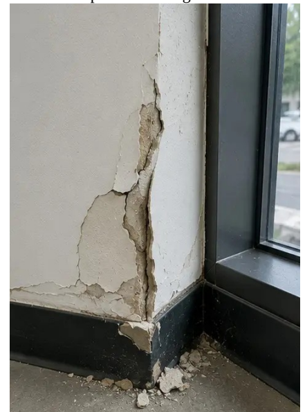
Photo #15. Area difettosa identificata documentata per ulteriore valutazione
