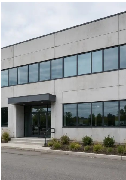
Photo #2. Stato della facciata anteriore durante l'ispezione
