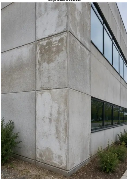
Photo #4. Stato delle pareti esterne registrato durante l'ispezione
