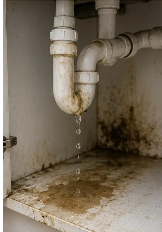
Foto №11 Danno da perdita idraulica documentato
