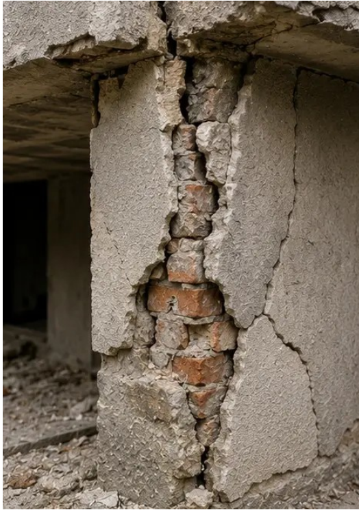
Foto №13 Dettaglio del danno strutturale documentato per la valutazione
