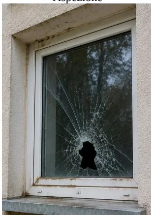
Photo #7. Finestra danneggiata documentata per la valutazione
