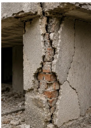
Photo #13. Dettaglio del danno strutturale documentato per la valutazione
