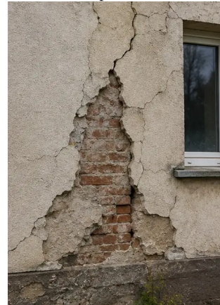
Photo #4. Danno alla parete esterna documentato per la valutazione
