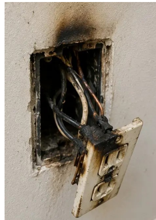
Photo #12. Danno all'impianto elettrico registrato durante l'ispezione
