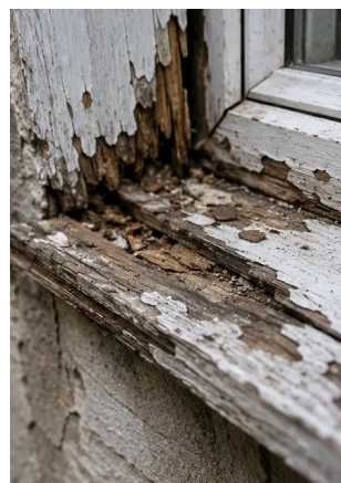
Photo #14. Primo piano fotografico del danno identificato come prova
