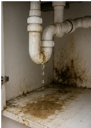
Photo #11. Danno da perdita idraulica documentato
