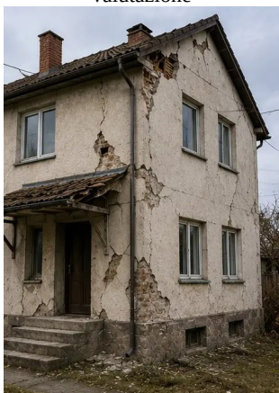
Photo #15. Panoramica di più punti di danno
