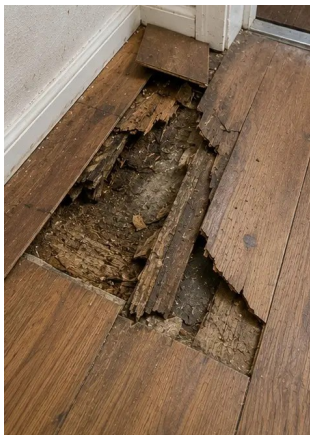
Photo #9. Pavimentazione danneggiata documentata durante l'ispezione
