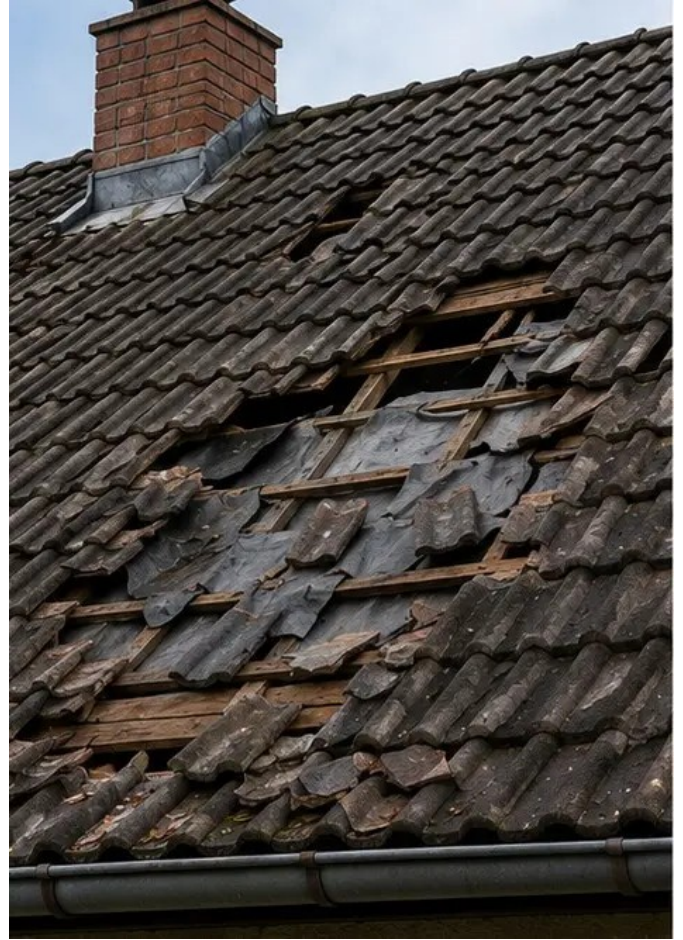
Foto №3 Area del tetto danneggiata identificata e registrata
