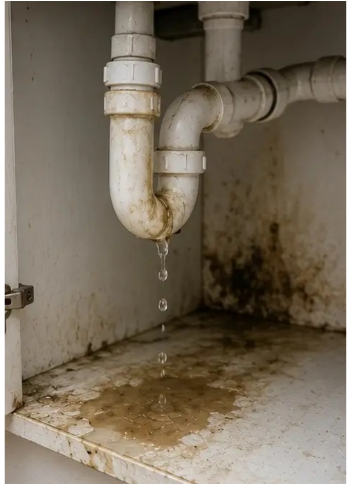
Foto №11 Danno da perdita idraulica documentato
