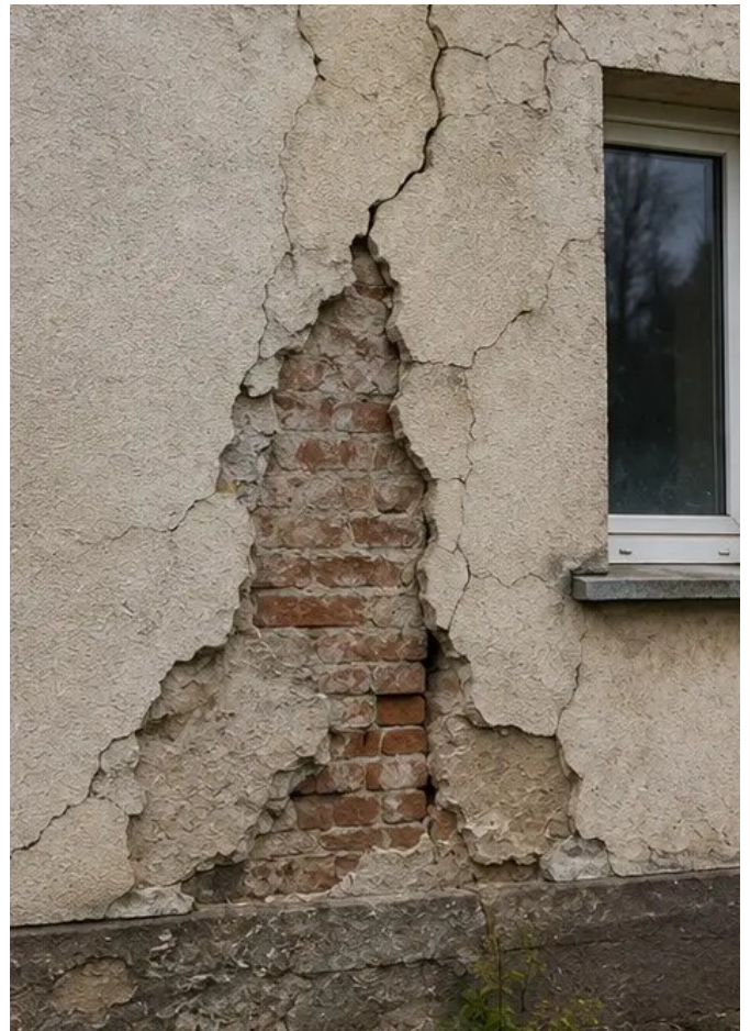
Foto №4 Danno alla parete esterna documentato per la valutazione
