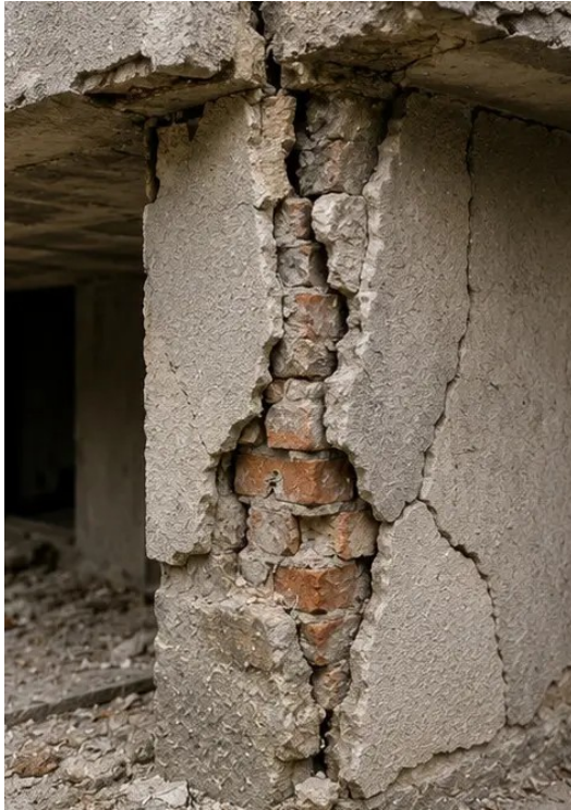
Foto №13 Detail kerusakan struktural didokumentasikan untuk penilaian
