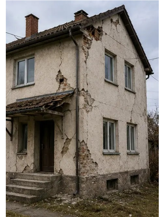
Foto №15 Gambaran beberapa lokasi kerusakan
