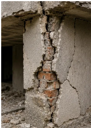
Photo #13. Detail kerusakan struktural didokumentasikan untuk penilaian
