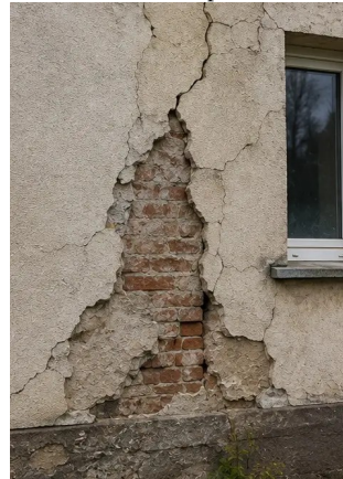
Photo #4. Kerusakan dinding luar didokumentasikan untuk penilaian
