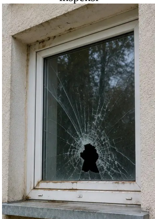
Photo #7. Jendela rusak didokumentasikan untuk evaluasi
