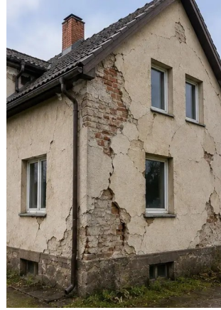
Photo #2. Gambaran kerusakan eksterior yang didokumentasikan selama inspeksi
