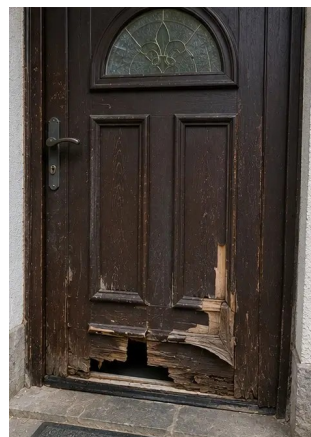
Photo #8. Pintu masuk rusak tercatat selama inspeksi
