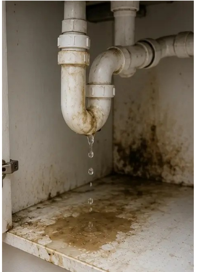
Foto №11 Kerusakan akibat kebocoran pipa didokumentasikan
