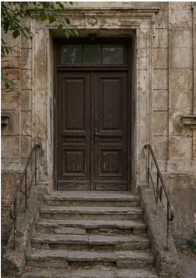
Foto №15 Pintu masuk properti sebelum perbaikan
