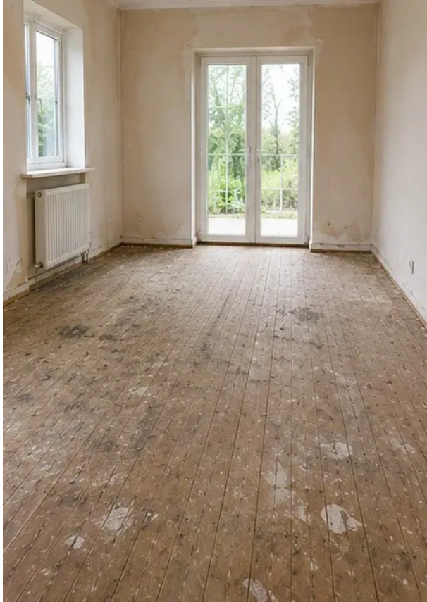
Foto №5 Kondisi lantai sebelum penggantian
