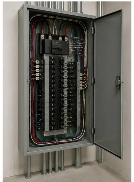
Photo #9. Kondisi panel listrik didokumentasikan
