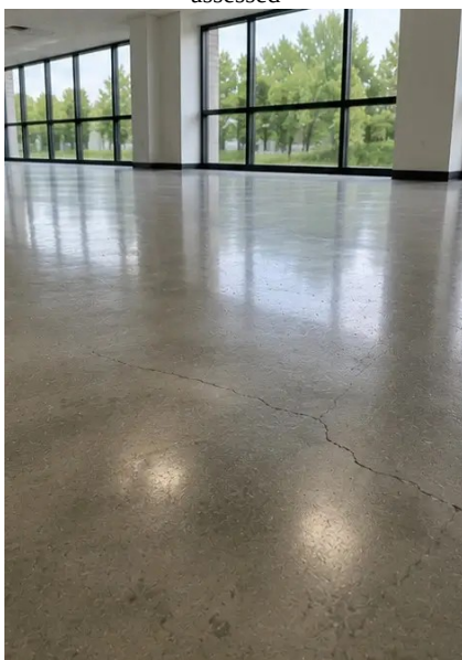
Photo #14. Kondisi lantai dinilai dan dicatat
