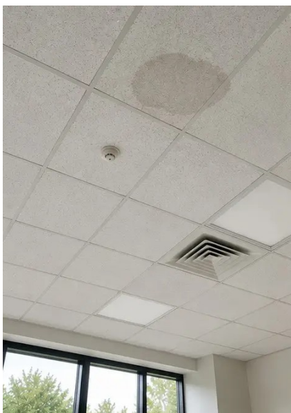
Photo #13. Kondisi langit-langit didokumentasikan selama inspeksi
