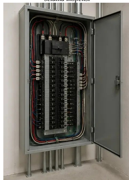
Photo #9. Kondisi panel listrik didokumentasikan
