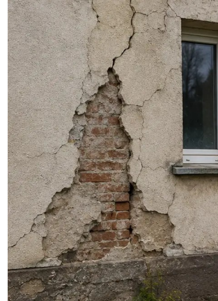
Photo #4. Külső fal sérülése dokumentálva értékeléshez
