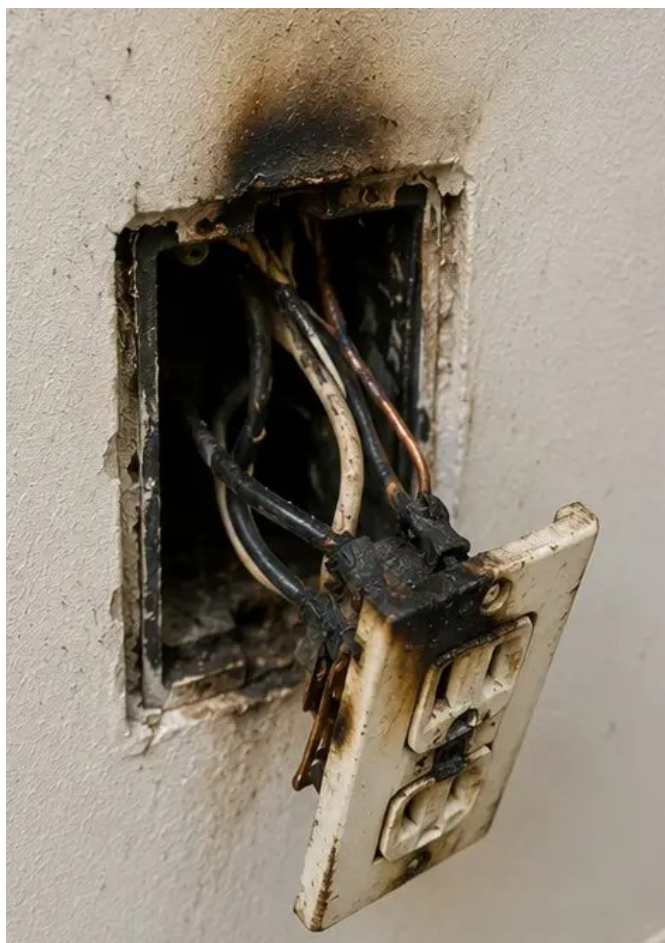
Fotó №12 Elektromos rendszer sérülése rögzítve az ellenőrzés során
