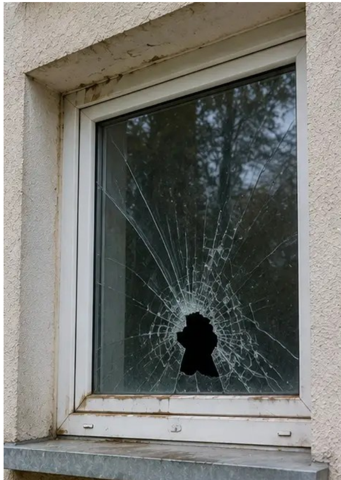
Fotó №7 Sérült ablak dokumentálva értékeléshez
