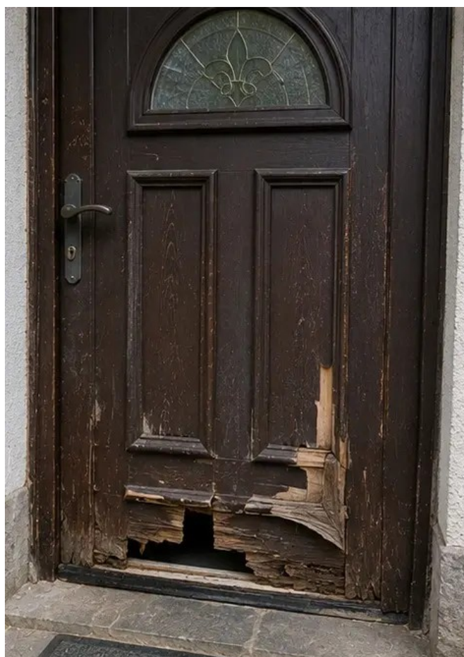
Fotó №8 Sérült bejárati ajtó rögzítve az ellenőrzés során
