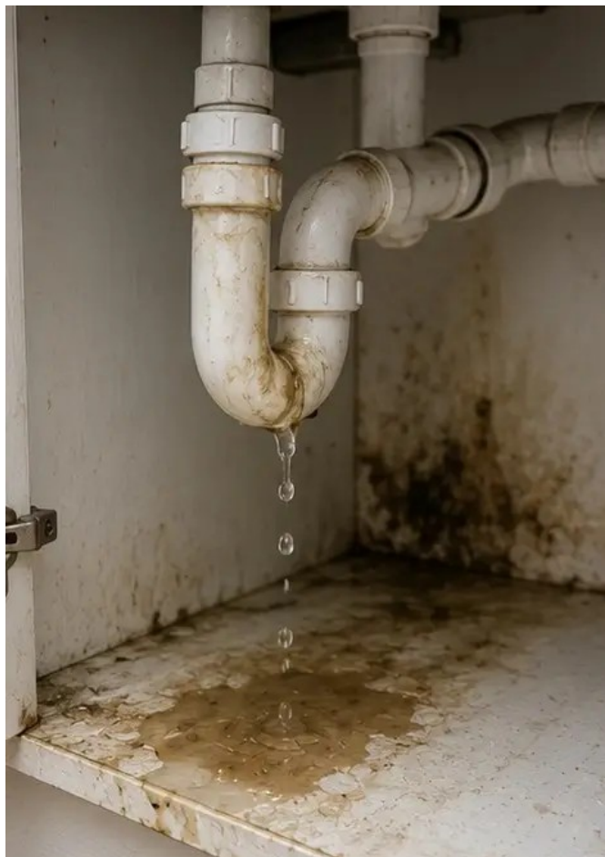
Fotó №11 Vízvezeték szivárgás okozta kár dokumentálva
