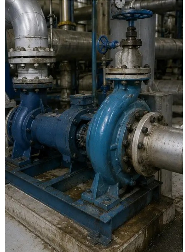
Fotó №3. Ipari szivattyú állapota értékelve karbantartás során
