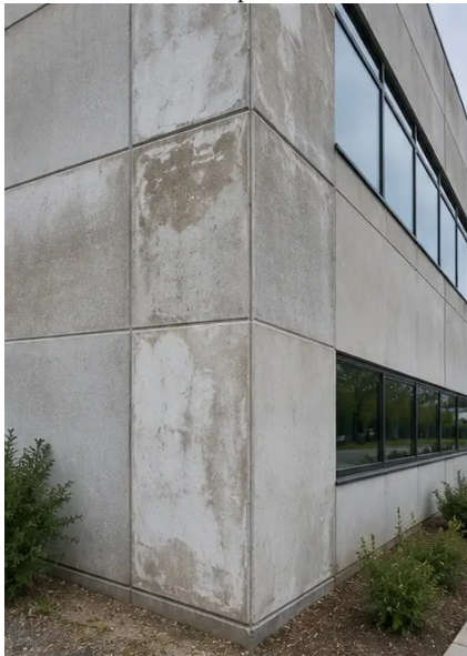
Photo #4. Külső falak állapota rögzítve az ellenőrzés során
