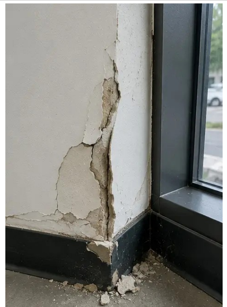
Photo #15. Azonosított hiba terület dokumentálva további értékelésre
