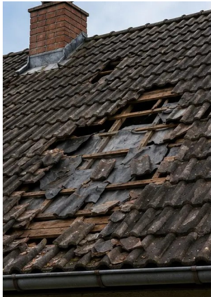
Photo #3. Oštećeno područje krova identificirano i zabilježeno
