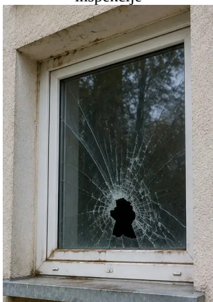
Photo #7. Oštećeni prozor dokumentiran za procjenu
