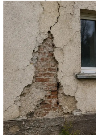
Photo #4. Oštećenje vanjskog zida dokumentirano za procjenu
