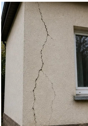
Photo #5. Pukotina na nosivom zidu dokumentirana tijekom inspekcije
