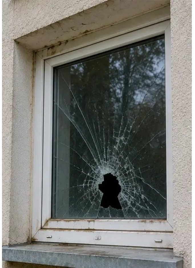
Fotografija br.7 Oštećeni prozor dokumentiran za procjenu
