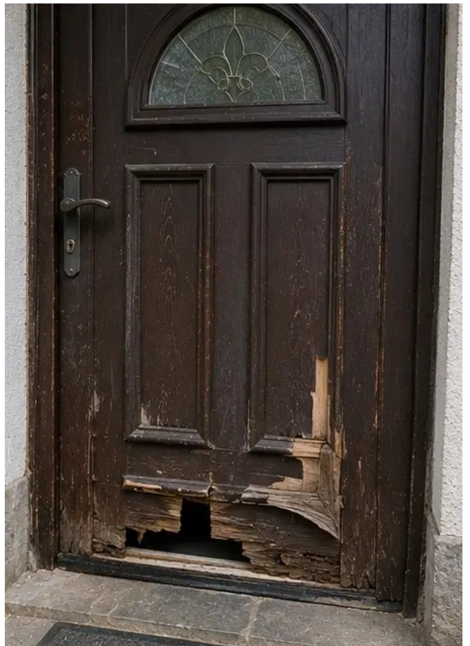
Fotografija br.8 Oštećena ulazna vrata zabilježena tijekom inspekcije
