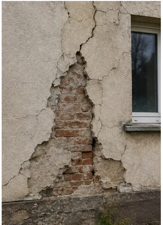
Fotografija br.4 Oštećenje vanjskog zida dokumentirano za procjenu
