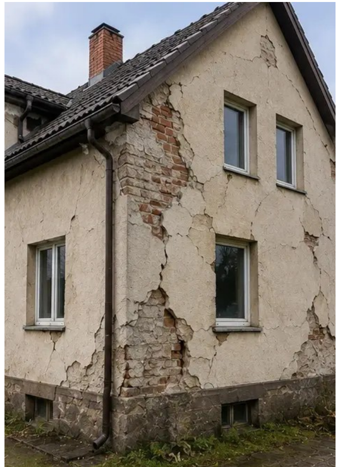
Fotografija br.2 Pregled vanjskih oštećenja dokumentiranih tijekom inspekcije
