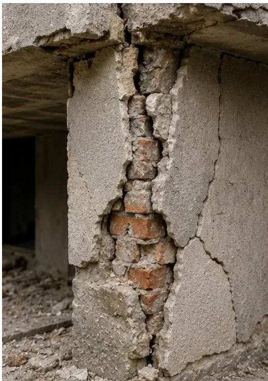
Fotografija br.13 Detalj konstruktivnog oštećenja dokumentiran za procjenu
