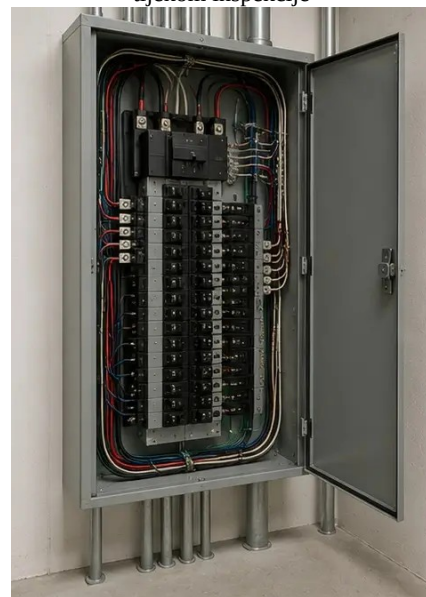
Photo #9. Stanje električne ploče dokumentirano
