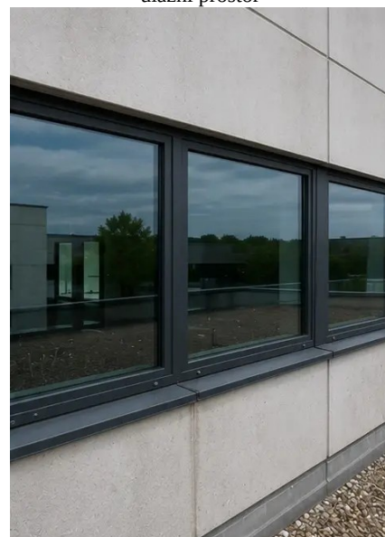
Photo #6. Stanje prozora dokumentirano tijekom inspekcije
