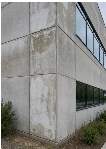
Photo #4. Stanje vanjskih zidova zabilježeno tijekom inspekcije
