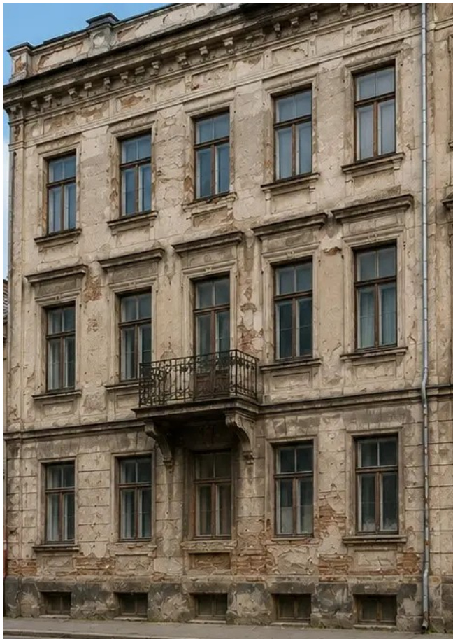
Fotografija br.13 Fasada zgrade prije restauratorskih radova
