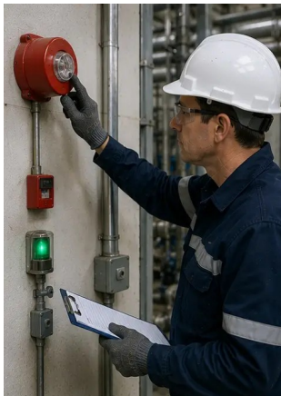
फोटो №13. सुरक्षा प्रणाली निरीक्षण पूर्ण
