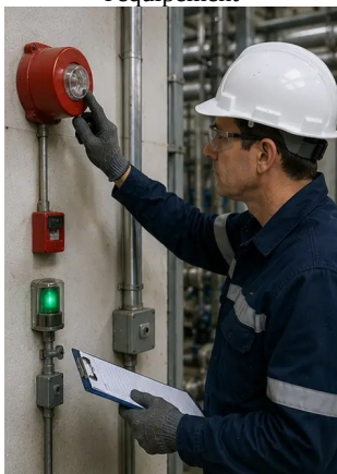
Photo n°13. Inspection du système de sécurité terminée
