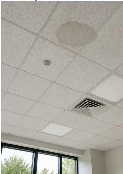
Photo #13. État du plafond documenté lors de l'inspection
