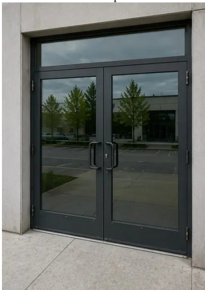
Photo #7. État des portes inspecté et enregistré
