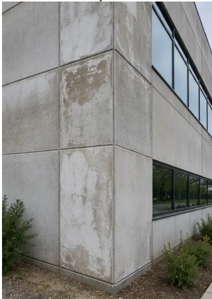
Photo #4. État des murs extérieurs enregistré lors de l'inspection
