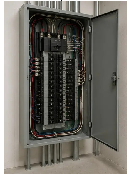
Photo #9. État du tableau électrique documenté
