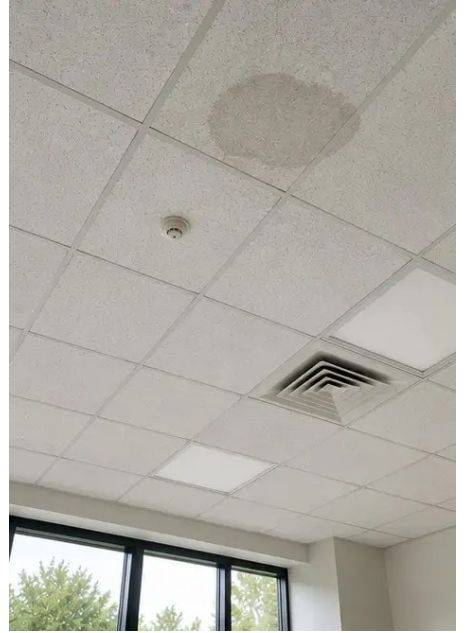
Photo #13. État du plafond documenté lors de l'inspection
