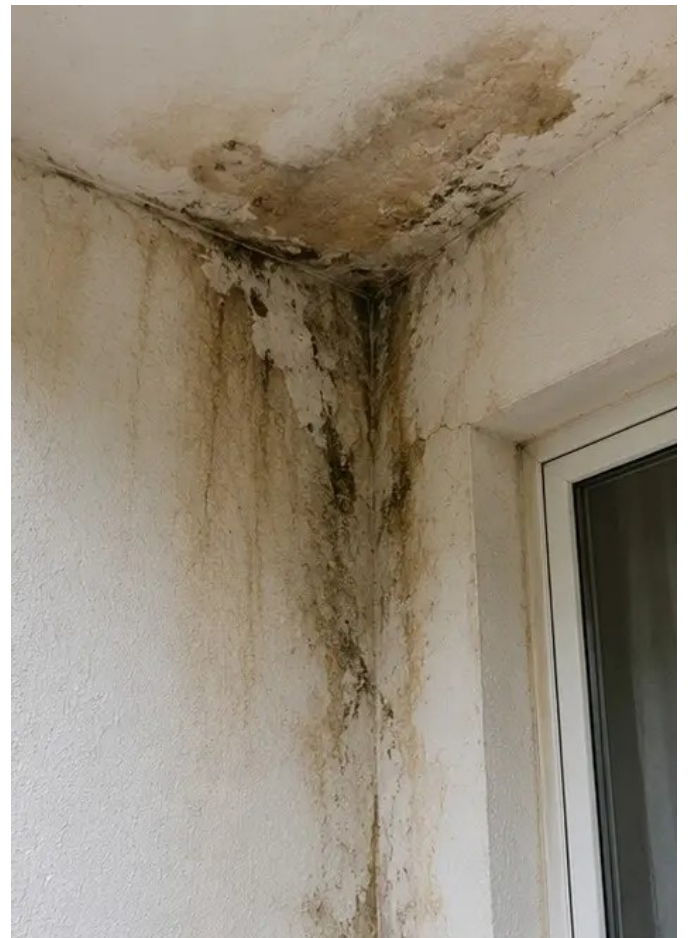
Photo n°6 Zone de dégât des eaux identifiée et enregistrée
