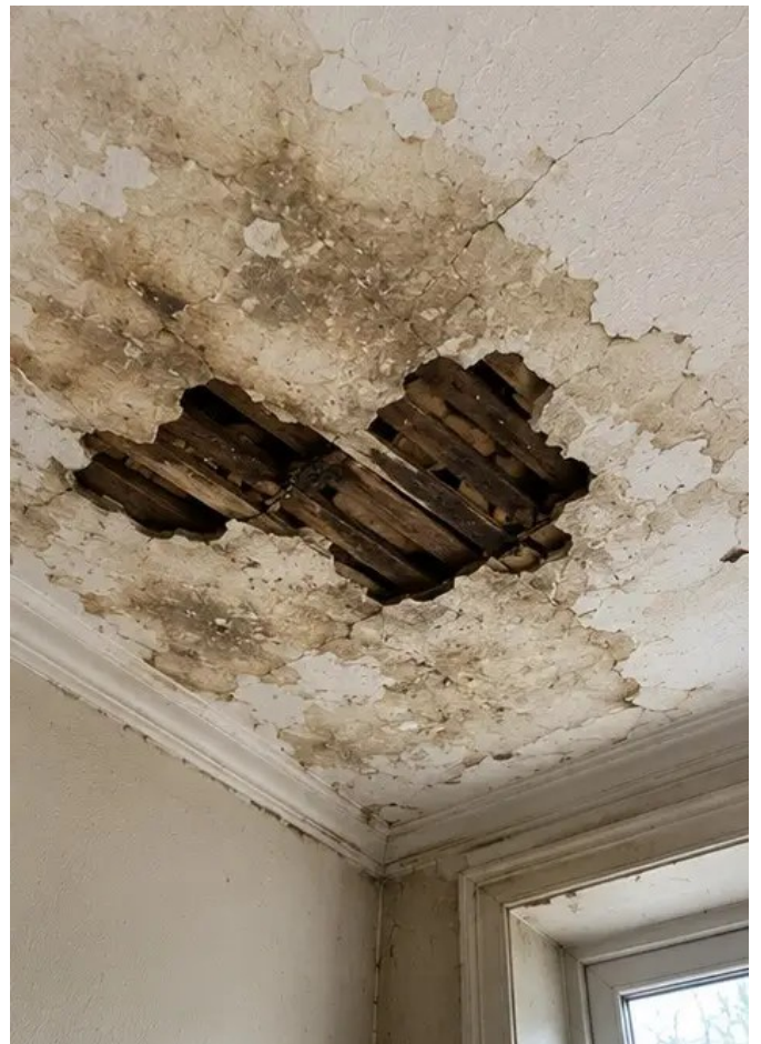
Photo n°10 Dommage au plafond identifié et enregistré
