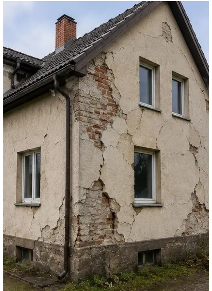
Photo n°2 Aperçu des dommages extérieurs documentés lors de l'inspection
