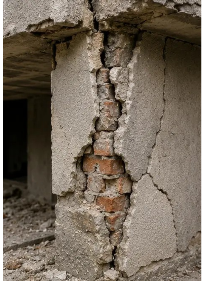
Photo n°13 Détail des dommages structurels documenté pour évaluation
