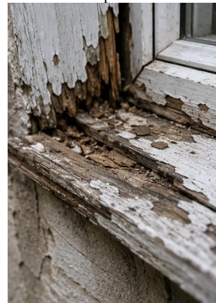
Photo #14. Photographie de preuve rapprochée des dommages identifiés
