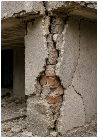
Photo #13. Détail des dommages structurels documenté pour évaluation
