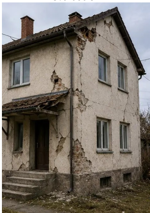
Photo #15. Aperçu de plusieurs emplacements de dommages
