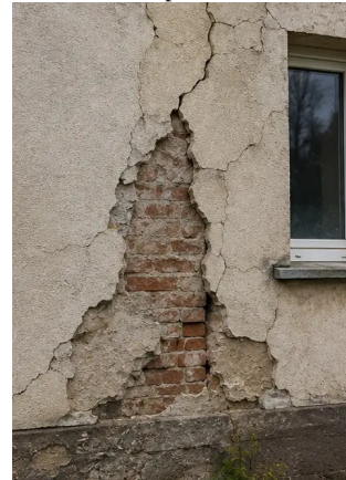
Photo #4. Dommage au mur extérieur documenté pour évaluation
