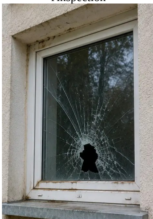
Photo #7. Fenêtre endommagée documentée pour évaluation
