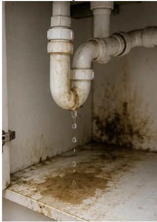
Photo #11. Dommage dû à une fuite de plomberie documenté
