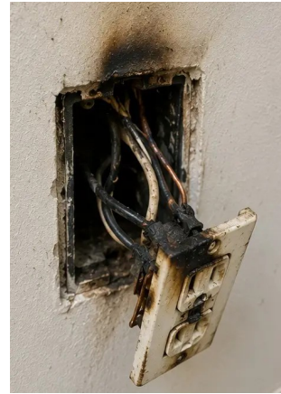
Photo #12. Dommage au système électrique enregistré lors de l'inspection
