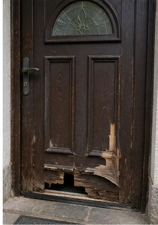
Kuva №8 Vaurioitunut ulko-ovi kirjattu tarkastuksen aikana
