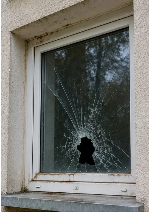
Kuva №7 Vaurioitunut ikkuna dokumentoitu arviointia varten
