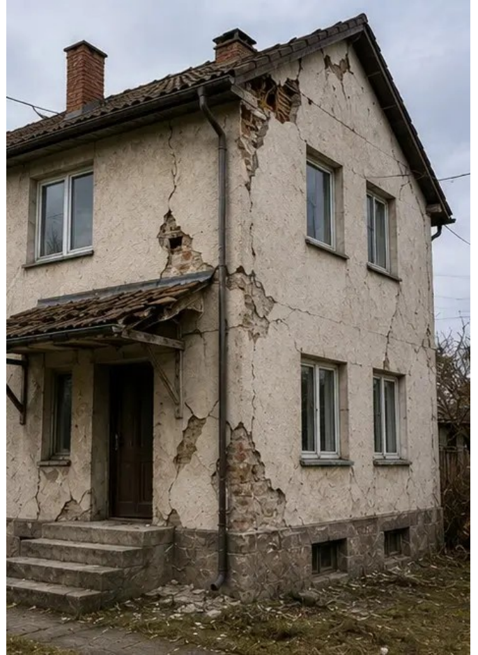
Kuva №15 Yhteenveto useista vauriokohdista
