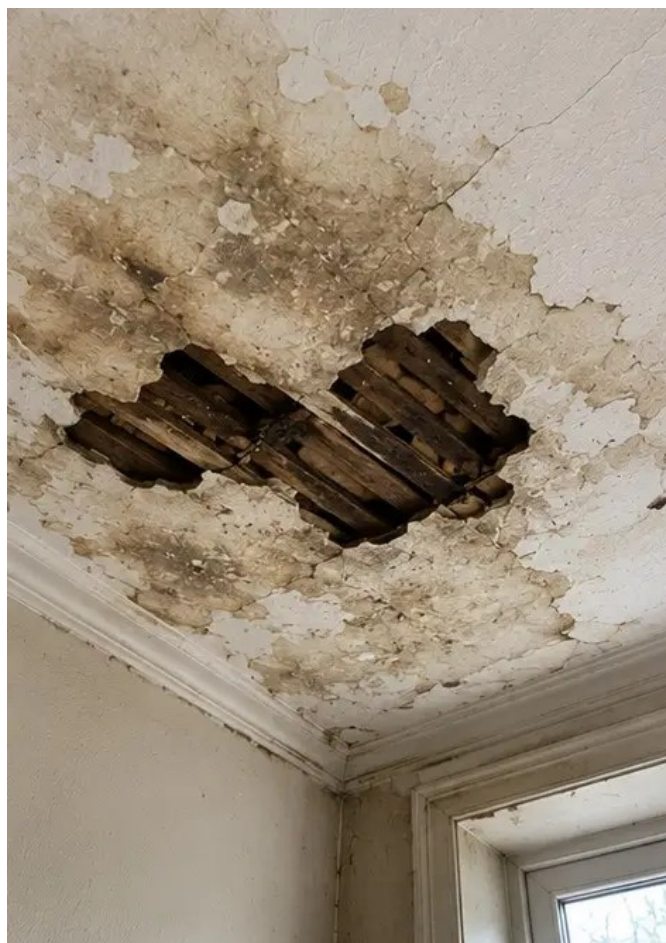
Kuva №10 Kattovaurio tunnistettu ja kirjattu
