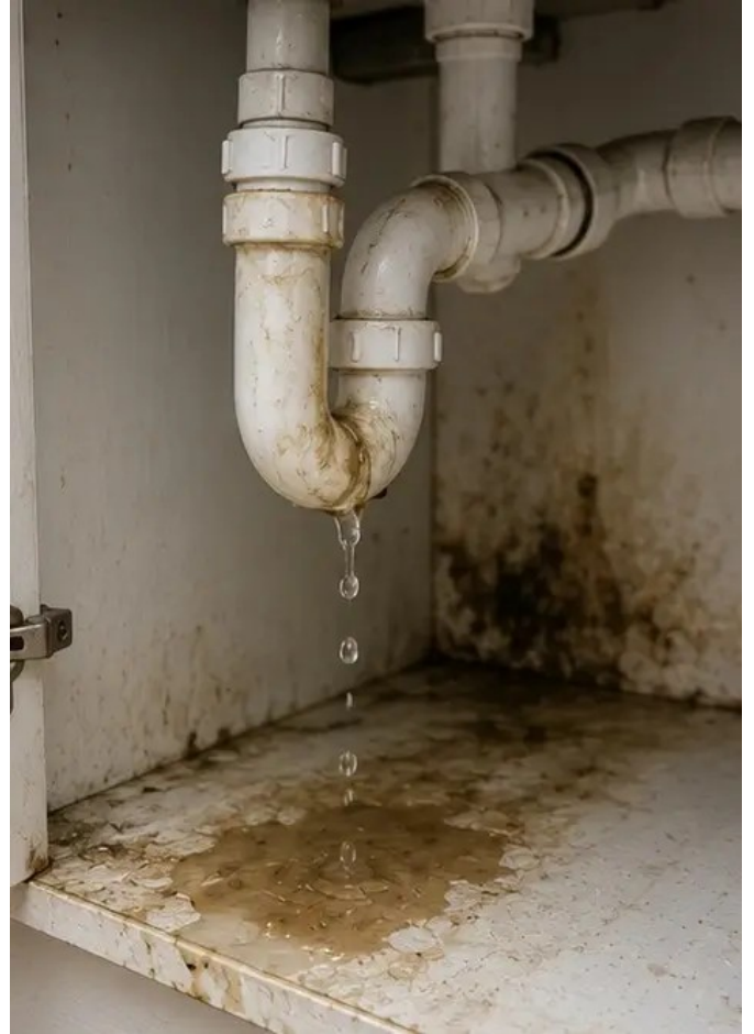
Kuva №11 Putkivuotovahinko dokumentoitu
