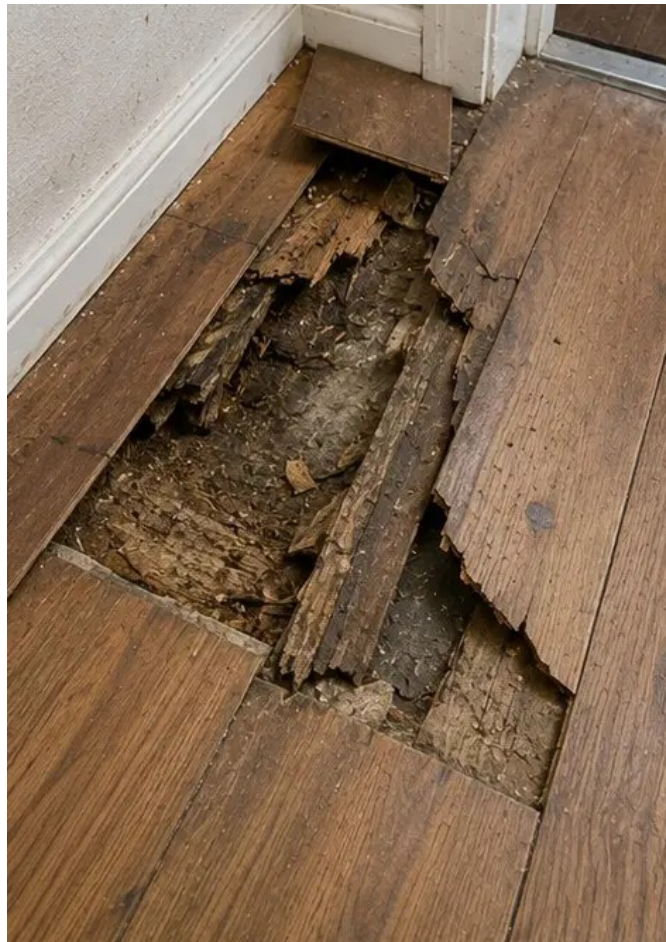
Kuva №9 Vaurioitunut lattia dokumentoitu tarkastuksen aikana
