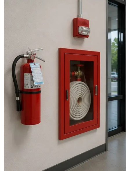
Photo #12. Turvalaitteet tarkastettu ja kirjattu
