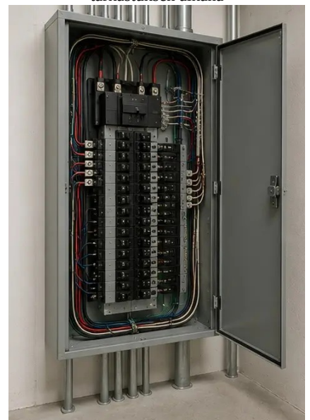
Photo #9. Sähköpääkeskuksen kunto dokumentoitu
