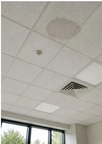
Photo #13. Katon kunto dokumentoitu tarkastuksen aikana
