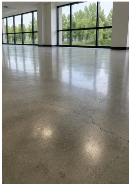
Photo #14. Lattian kunto arvioitu ja kirjattu
