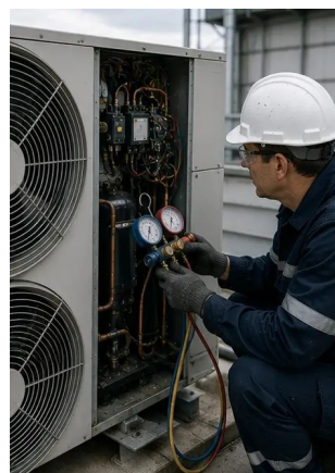
Kuva №6. LVI-laitteiden kunto dokumentoitu
