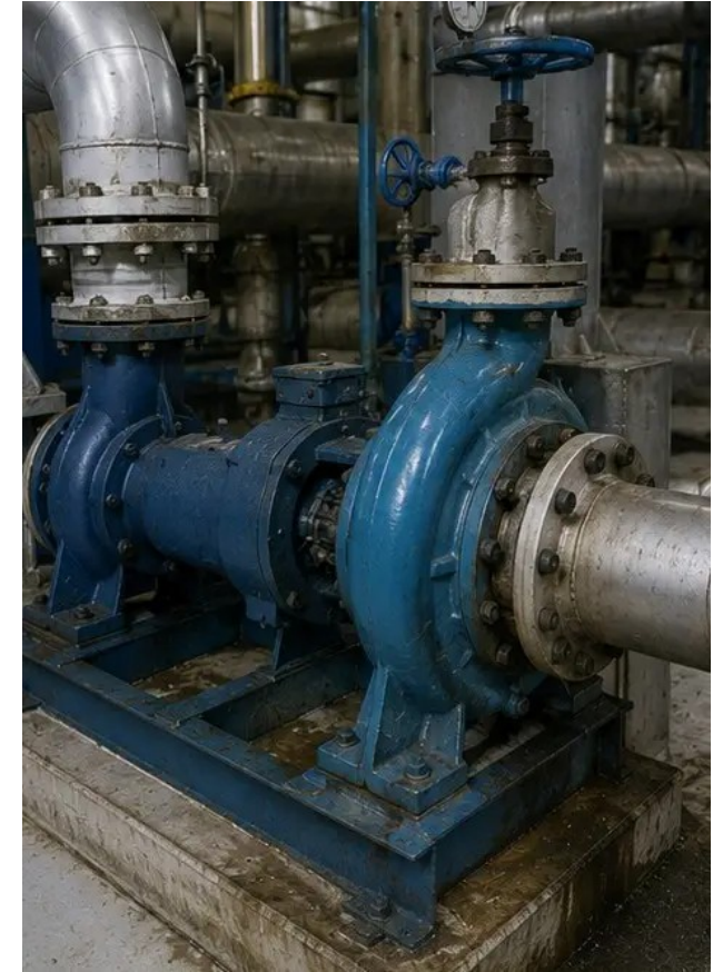
Kuva №3. Teollisuuspumpun kunto arvioitu huollon aikana
