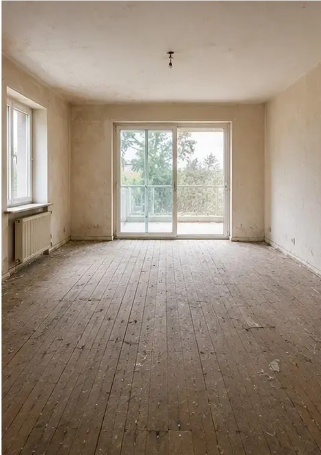
Kuva №1 Olohuoneen kunto ennen remonttia
