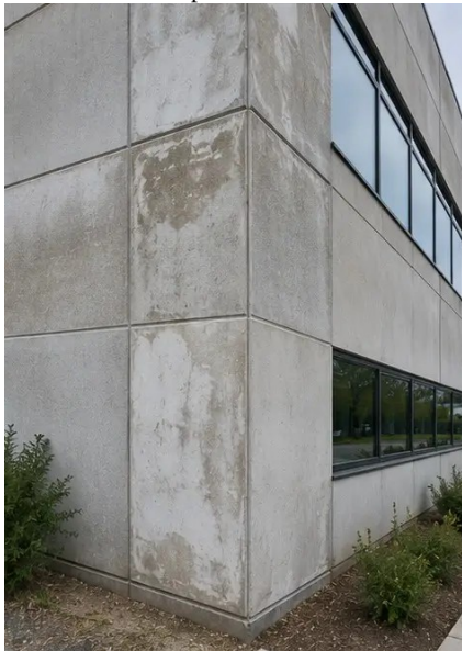
Photo #4. Estado de las paredes exteriores registrado durante la inspección
