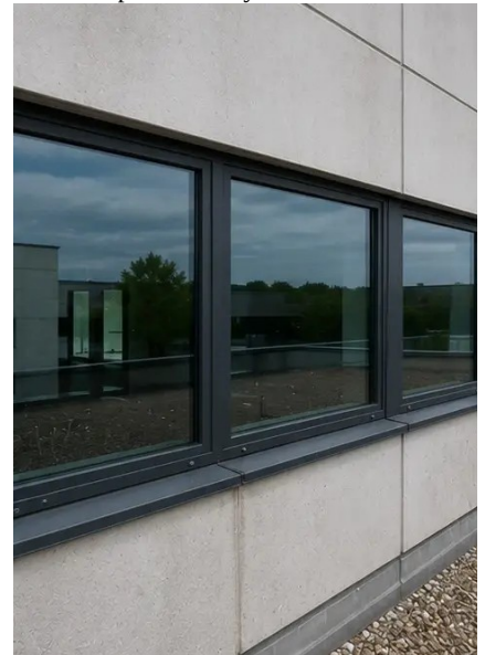
Photo #6. Estado de las ventanas documentado durante la inspección
