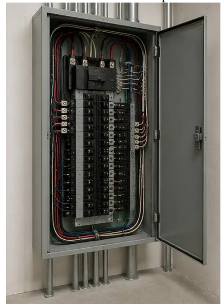
Photo #9. Estado del panel eléctrico documentado
