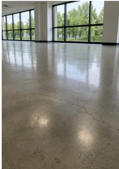
Photo #14. Estado del piso evaluado y registrado
