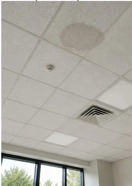
Photo #13. Estado del techo documentado durante la inspección
