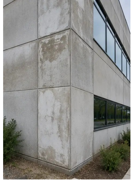
Photo #4. Estado de las paredes exteriores registrado durante la inspección
