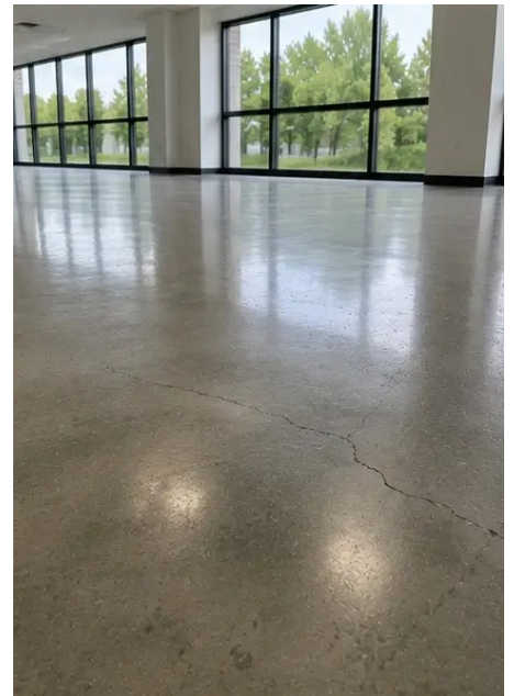
Photo #14. Estado del piso evaluado y registrado
