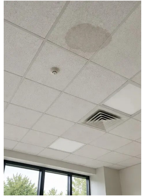
Photo #13. Estado del techo documentado durante la inspección
