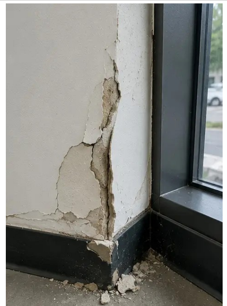
Photo #15. Área con defecto identificada documentada para evaluación adicional
