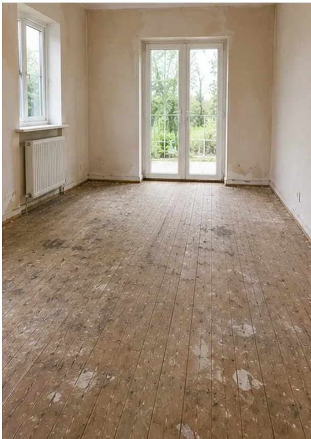
Foto N°5 Estado del piso antes del reemplazo
