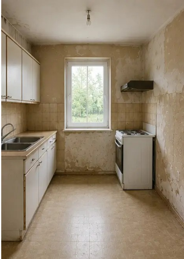
Foto No11 Estado de la cocina antes de la renovación
