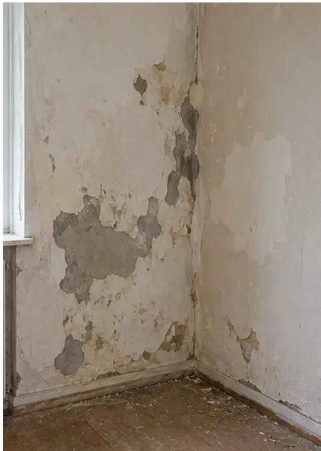
Foto No3 Estado de la pared antes de los trabajos de reparación
