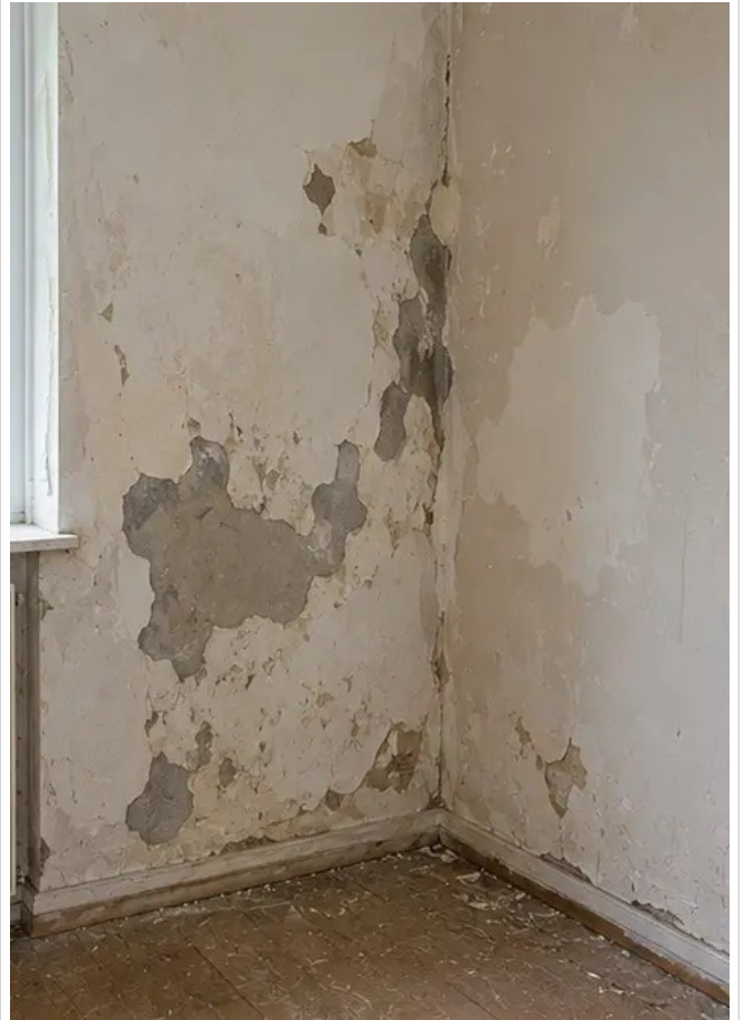
Foto №3 Estado de la pared antes de los trabajos de reparación
