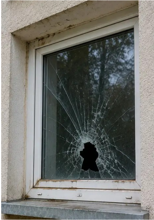
Foto №7 Ventana dañada documentada para evaluación
