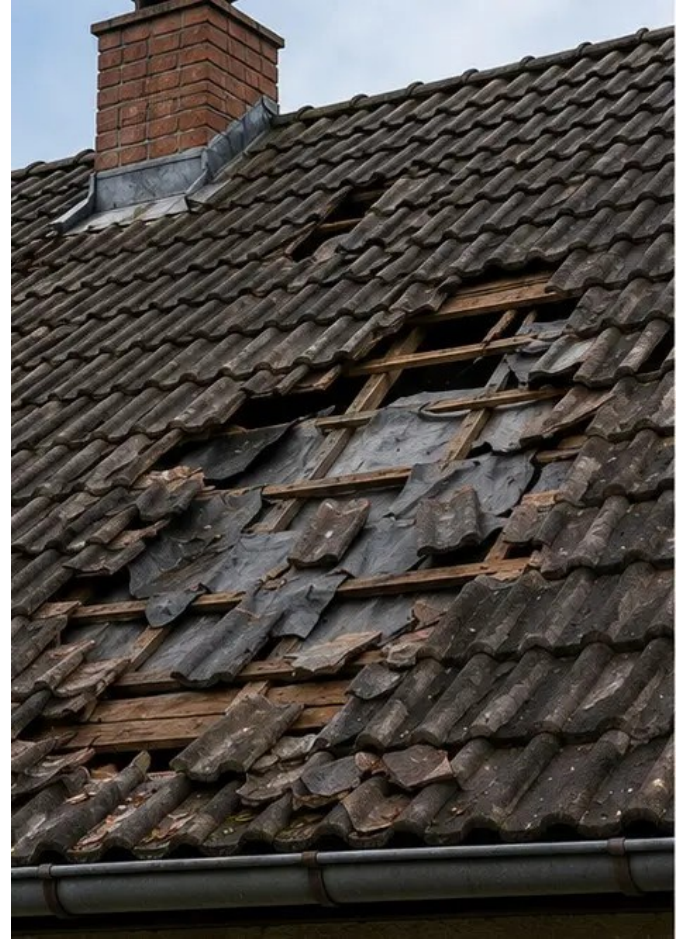
Foto №3 Área del techo dañada identificada y registrada
