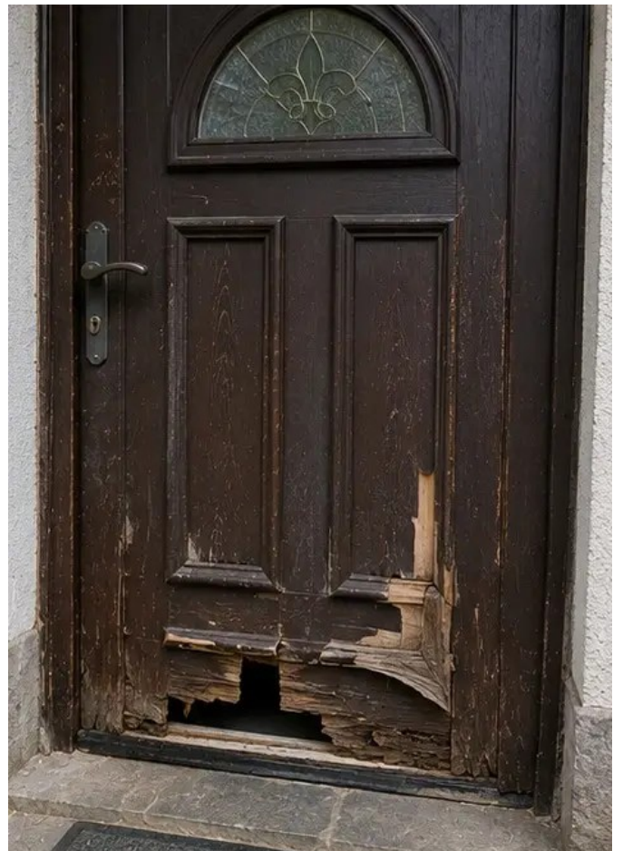
Foto №8 Puerta de entrada dañada registrada durante la inspección
