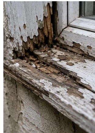
Photo #14. Fotografía en primer plano de evidencia del daño identificado
