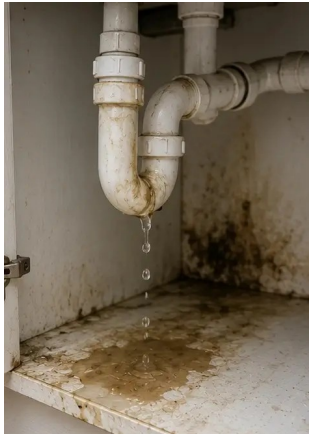
Photo #11. Daño por fuga de plomería documentado
