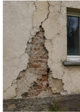
Photo #4. Daño en pared exterior documentado para evaluación
