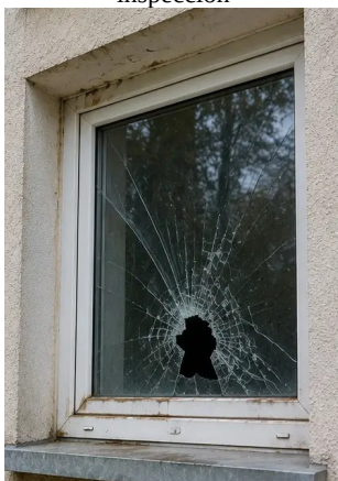
Photo #7. Ventana dañada documentada para evaluación
