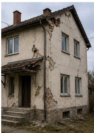
Photo #15. Resumen de múltiples ubicaciones de daños
