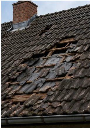
Photo #3. Área del techo dañada identificada y registrada
