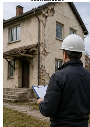
Photo #16. Fotografía resumen final de la inspección de daños
