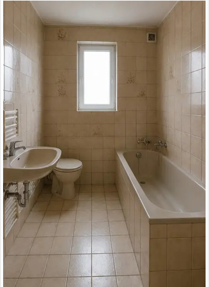
Φωτογραφία Νο9 Κατάσταση μπάνιου πριν την ανακαίνιση
