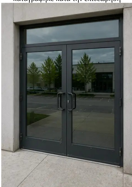
Photo #7. Κατάσταση θυρών επιθεωρήθηκε και καταγράφηκε
