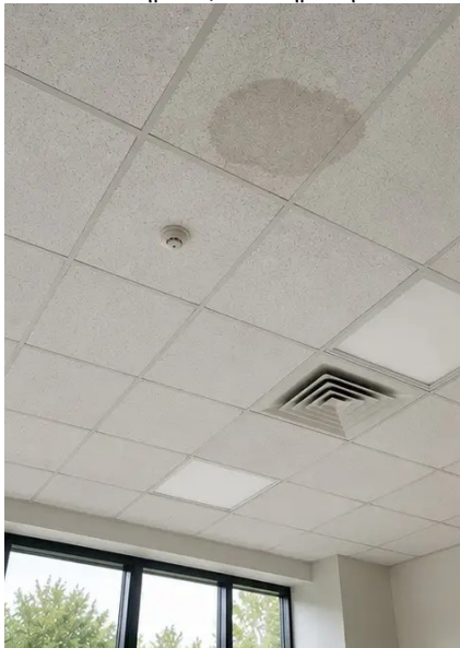
Photo #13. Κατάσταση οροφής τεκμηριώθηκε κατά την επιθεώρηση
