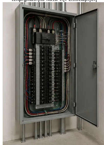
Photo #9. Κατάσταση ηλεκτρικού πίνακα τεκμηριώθηκε
