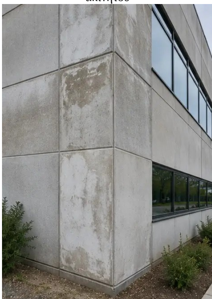
Photo #4. Κατάσταση εξωτερικών τοίχων καταγράφηκε κατά την επιθεώρηση
