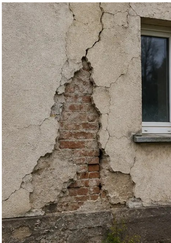
Φωτογραφία №4 Ζημιά εξωτερικού τοίχου τεκμηριώθηκε για αξιολόγηση
