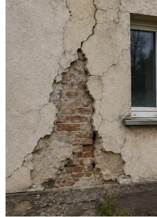
Photo #4. Ζημιά εξωτερικού τοίχου τεκμηριώθηκε για αξιολόγηση
