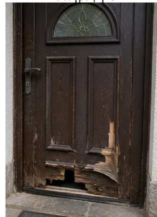
Photo #8. Κατεστραμμένη είσοδος καταγράφηκε κατά την επιθεώρηση
