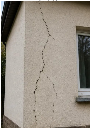
Photo #5. Ρωγμή σε φέροντα τοίχο τεκμηριώθηκε κατά την επιθεώρηση
